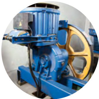
Com os cabos de tração convencionais, arranques e paragens bruscas.
